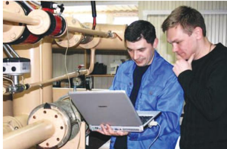
Подключение отопления - процесс технологичный.
